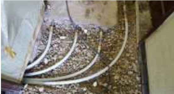
구조체에 배관이 매설되어 있어 수리시 콘크리트 벽체를 파괴해야 한다.
